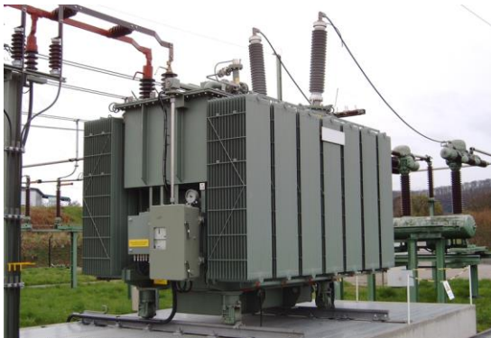
Fig. 4. Transformador de potencia.
